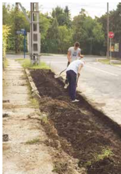
Bocskai elején a megsüllyedt aszfalt helyreállítása is szükséges
